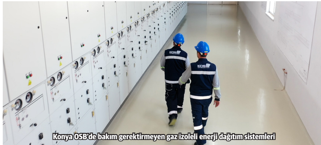
Uşak OSB enerji otomasyonu ve koruma özellikleriyle donatılmış dağıtım merkezi.
